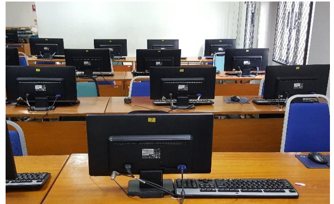
Pendawaian/kabel yang kemas dan selamat
